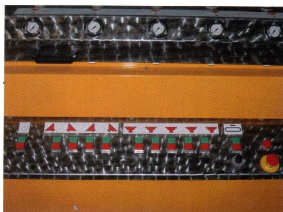
Painel de comando Electrico e Pneumatico
